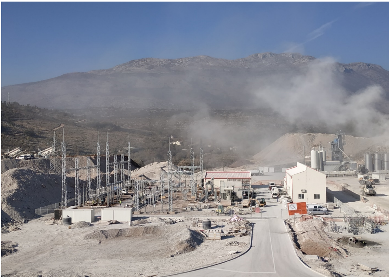
Slika 5.1: Visokonaponsko razvodno postrojenje 110/20 kV „Autoput 1 - Mrke”
